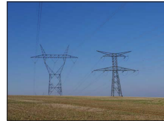
Pylones émergeant des parcelles cultivées à Darcey
