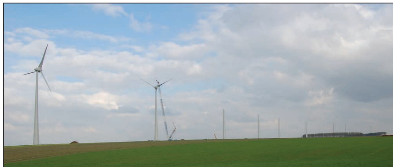
Figure 10: Travaux du projet « Le Nouvion », parc de 24 éoliennes en cours de réalisation
