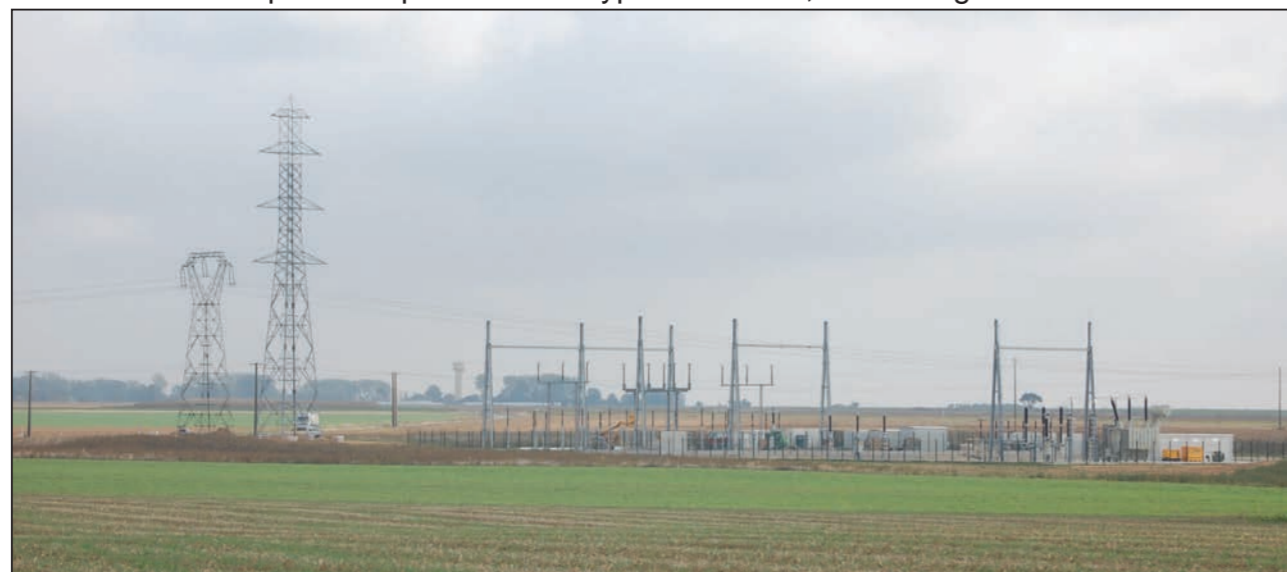
Figure 11: Poste de raccordement du parc éolien « Le Nouvion » à la ligne THT à 225 000 volts
