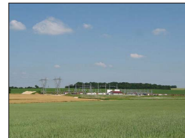
Figure 77: Nouveau poste électrique de Darcey
