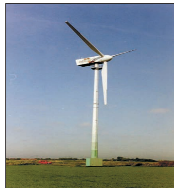
Figure 263: Éolienne type E-32
